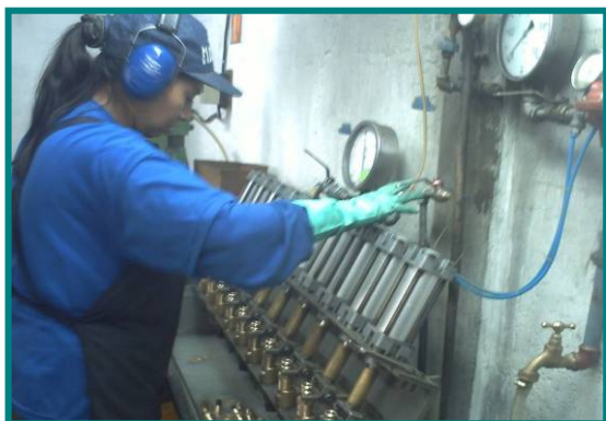
Fotografía No. 5.2-11 Área de verificación o prueba de funcionamiento de las válvulas
